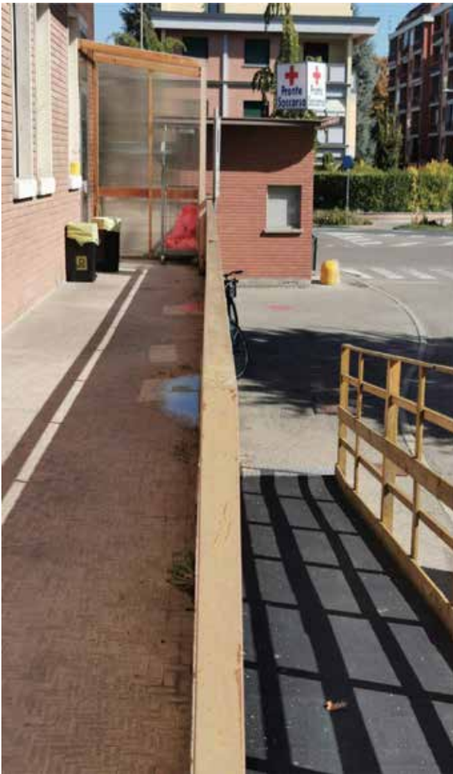
Fig. 3 - Ospedale di Carpi (MO). La rampa costruita il 16 marzo 2020 consente di raggiungere dall'esterno, attraverso un terrazzo, la stanza contumaciale per pazienti Covid. È tuttora in funzione.
